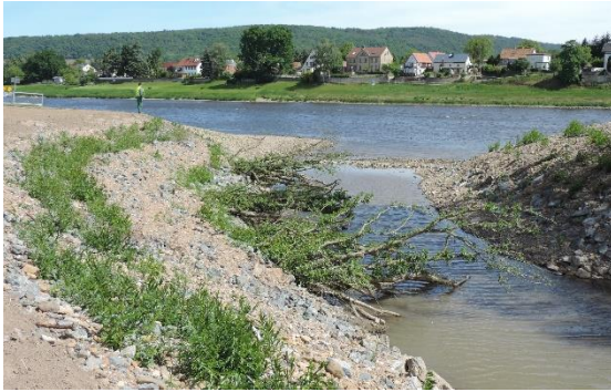
Foto 36: Die Ufersicherung des Seitenarmes wurde nur in Teilbereichen vorgenommen und vorrangig mit ingenieurbiologischen Bauweisen (Buschlagen und Lebende-Abweiser) ausgeführt. Bei Niedrigwasser verhindert eine Sohlschwelle das Leerlaufen des Seitenarmes. (Foto: STOWASSERPLAN)
