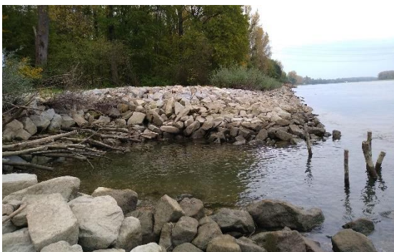
Foto 28: Einbau von Fischunterständen mit strömungsberuhigten Bereichen im Rahmen von Ufersanierungs- und Gestaltungsmaßnahmen. Der Einstrombereich
