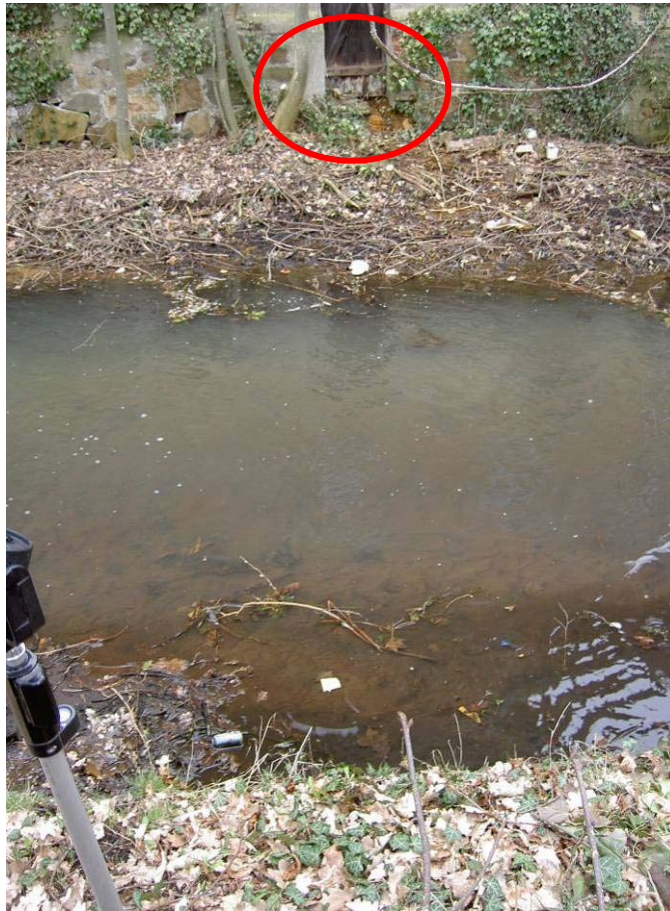
Abbildung 4-7: Problembereich D entlang der Stadtnuthe, Profil an der Stationierung 39226,51 (Foto: VPT, 2008)
